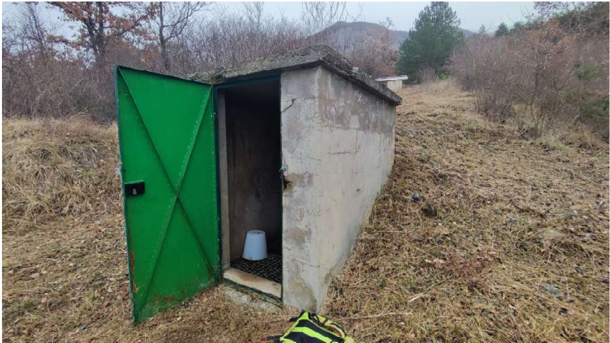
Photo 5 : Captage de la Brunette
