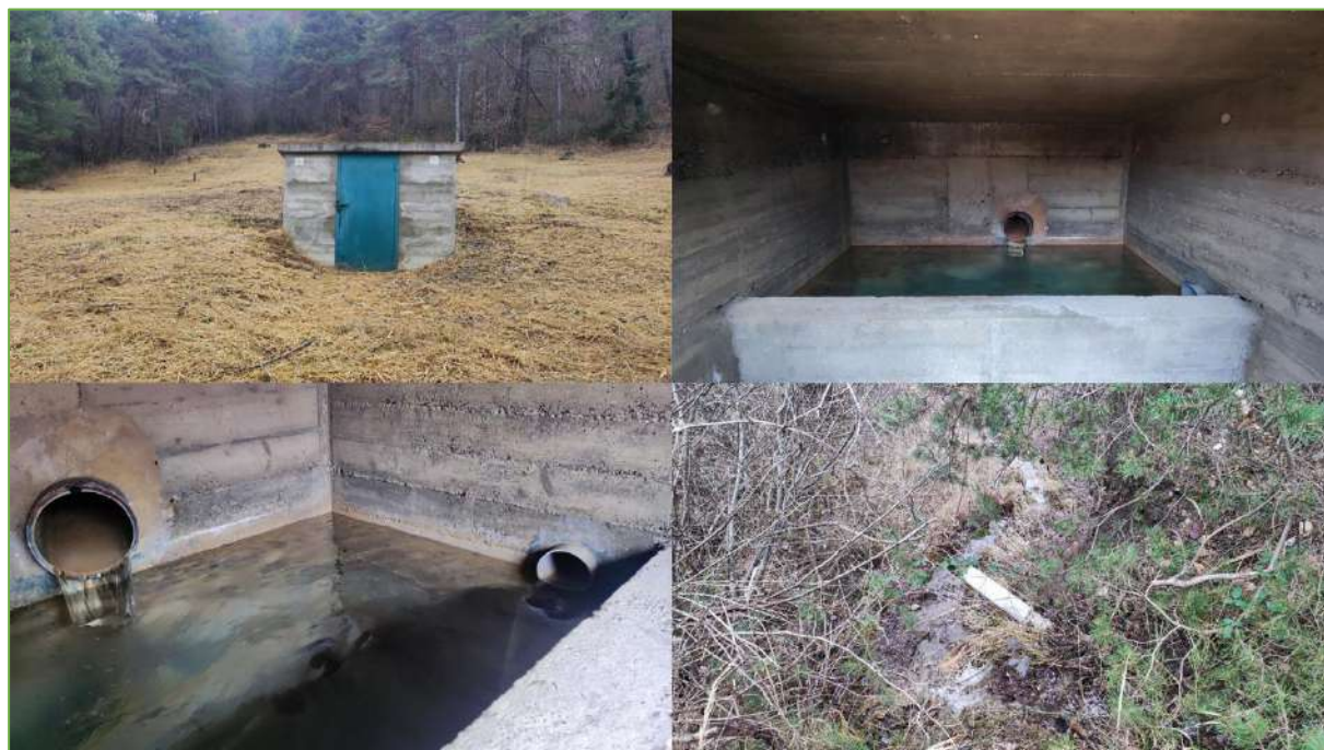
Figure 48 : photographies du captage de la source de la Brunette
