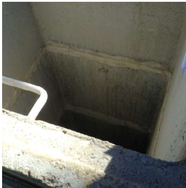
A3 : Photo, intérieur du captage Espigniers 1
